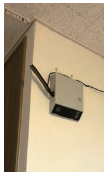
機器設置の様子
