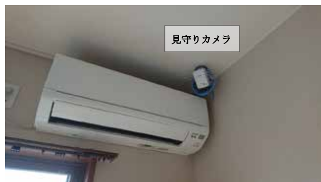
機器の設置状況
