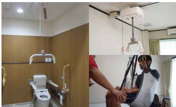
天井走行式リフターの導入によって部屋内の移動がスムーズになった
