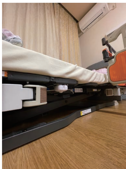
ベッド下に設置されたセンサー
