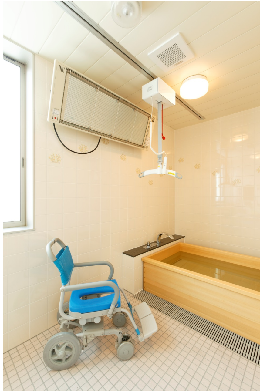
天井走行リフト（浴室内①）
