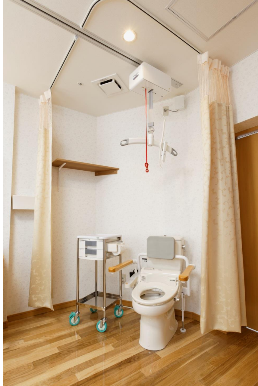
天井走行リフト(居室内トイレ)
