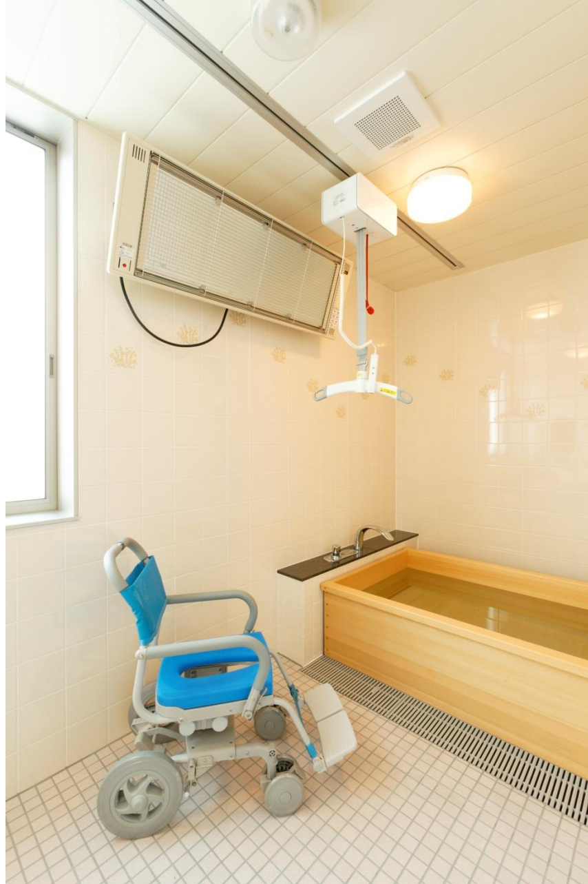
天井走行リフト(浴室内)
