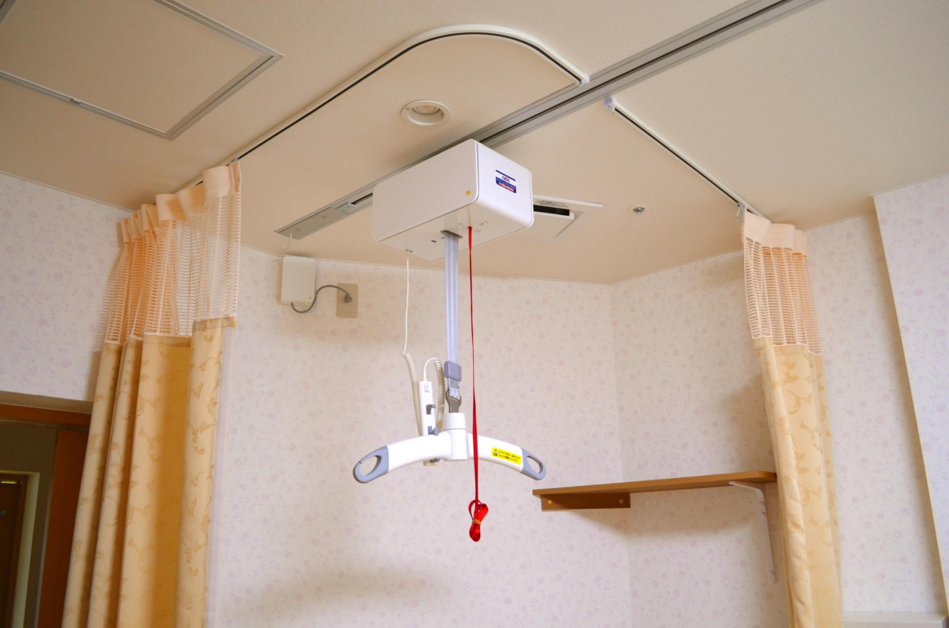
天井走行リフト(拡大)
