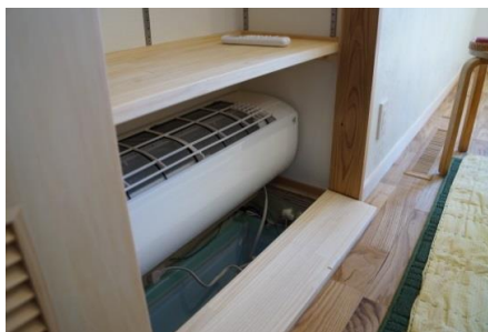
床下エアコン=床下に暖気を送って、床下空間全体を温めることによって、部屋間の温度差を解消した。高断熱・高気密だからできた、匠(大工)の技
